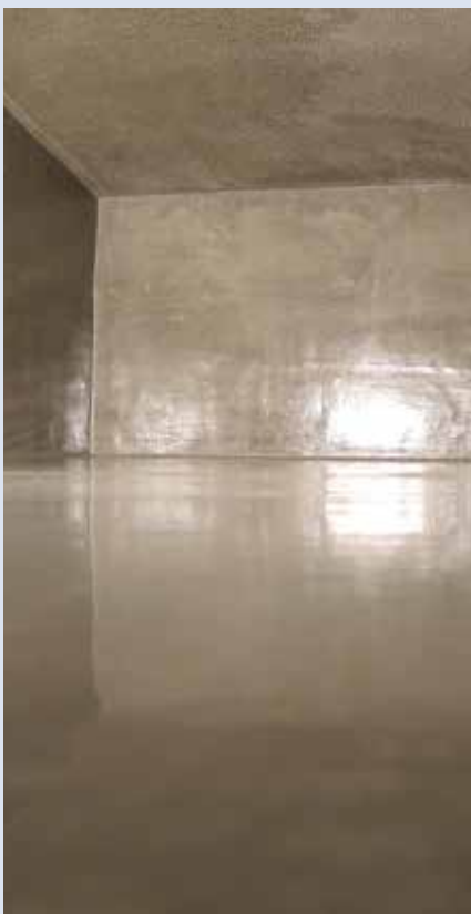
Резервоари за питейна вода
